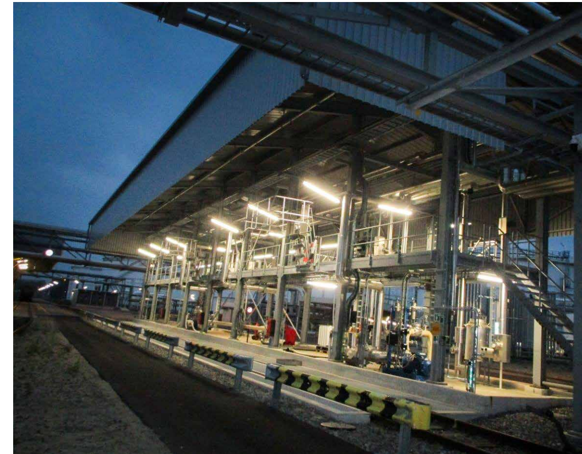
'Light versus lighting' leidt onder meer tot vermindering van de CO 2 -uitstoot doordat van gasontladinglampen wordt overgestapt naar LED, zoals hier bij Oiltanking in Terneuzen. (Foto: Oiltanking)
